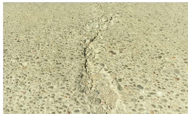
Frische Bruchstelle im Wirtschaftsweg, Austausch einer Platte ca. 5.000€.
